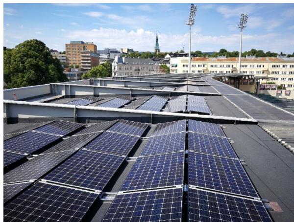
Figur 6: Solcelleanlegg på Bislett stadion i Oslo
